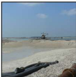
Stawa osadowa w ZG „Trzebionka” S.A.
