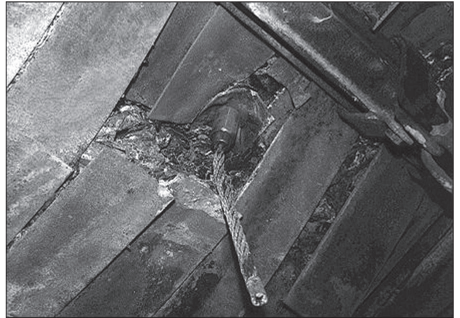
Rys. 6.3. Widoczne na podkładce znaczne obciążenie kotwi linowej
