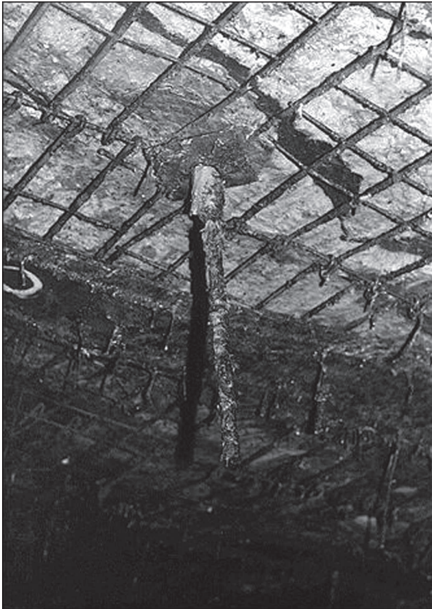
Rys. 4.1. Korozja zewnętrznego odcinka kotwi linowej
