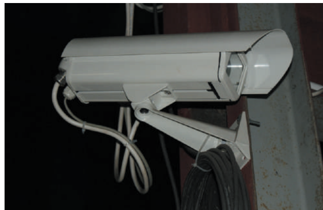
Rys. 2. Kamera powierzchniowa zainstalowana na nadszybiu szybu „Helena”
