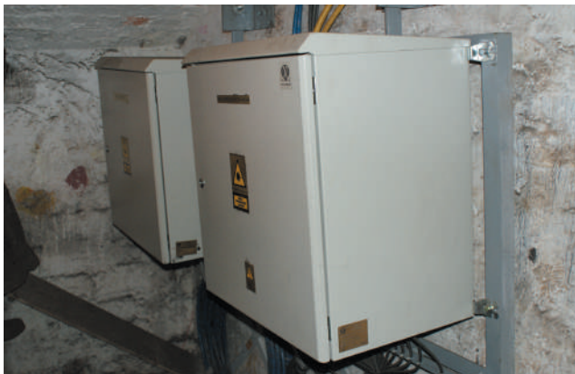
Rys. 5. Optoelektryczna stacja przetwornikowa ALFA-III
