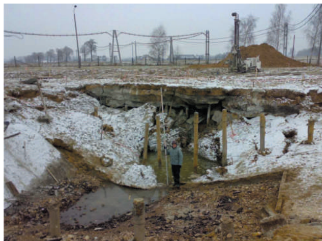
Rys. 5. KWK „Pniówek” – szyb V. Obszar badań mikrograwimetrycznych w rejonie deformacji nieciągłych wywołanych awarią lunety wentylacyjnej (fot. A. Modrzejewski)
