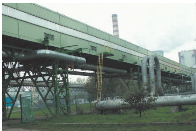
Fot. 1.6. Obudowane przenośniki nawęglania
