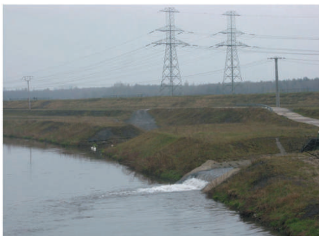
Rys. 8. Kanał odprowadzający wody dołowe z osadnika - wlot do rzeki Przemszy
