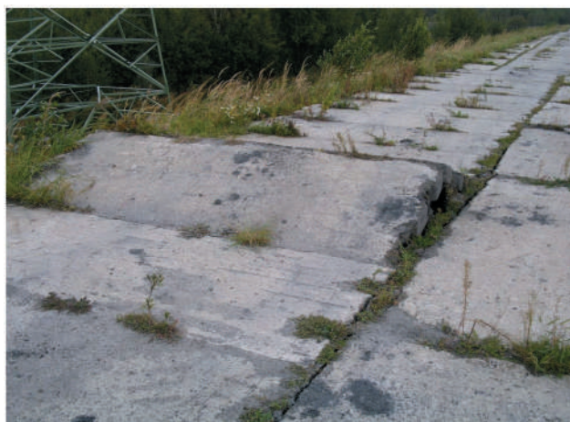
Rys. 15. Wypiętrzenia płyt betonowych drogi wokół zbiornika „Biały Brzeg”
