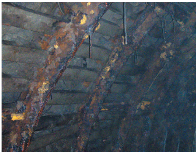
Rys. 1. Zaawansowana korozja całej obudowy - równomierny proces korozji
