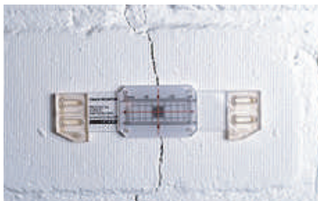
Rys. 14. Czujnik pomiarowy służący do monitoringu szczelin w warstwie betonu
