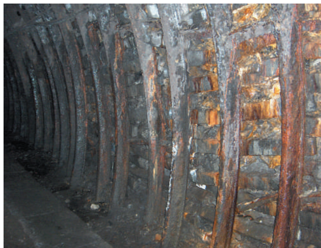
Rys. 2. Korozja łuków ociosowych obudowy postępująca do wysokości około 1 m
