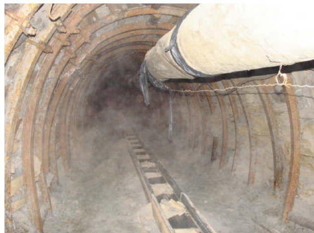
Fot. 4. Chodnik piętrowy z lutniociągiem i przenośnikiem SKAT-60
