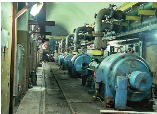
► Rys. 3. Pompownia głównego odwadniania – stan po przejęciu przez CZOK ► Fig. 3. Main drainage pumping station – state after takeover by CZOK
