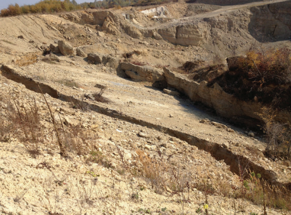
► Rys. 1. Warstwy nachylone w stronę wyrobiska, przewarstwienia skał o różnych parametrach wytrzymałościowych dolomit/lupek ilasty ► Fig. 1. Layers inclined towards the excavation, rock interbedding with different strength parameters dolomite/clayey
