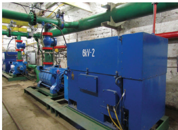
► Rys. 4. Pompownia głównego odwadniania – stan po modernizacji ► Fig. 4. Main drainage pumping station – state after modernization
