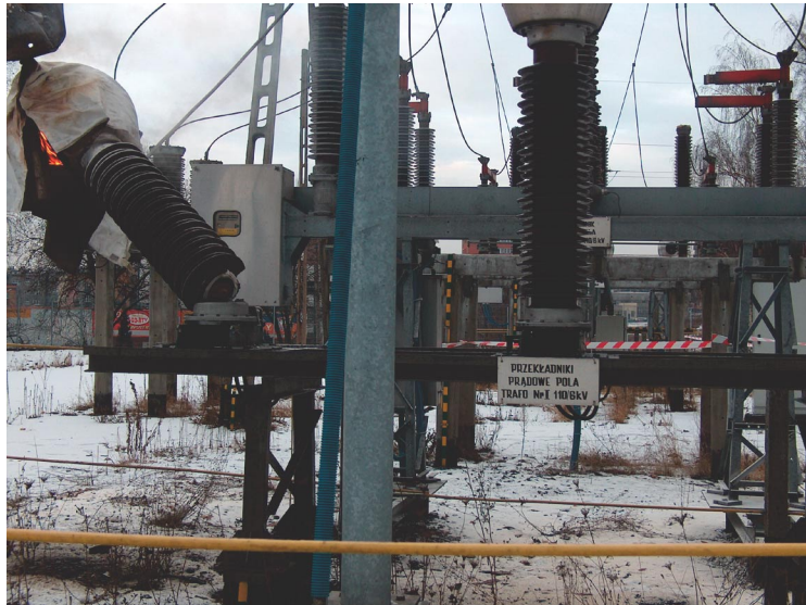
Fot. 4.3.1. KWK „Pokój” – uszkodzenie przekładnika prądowego
