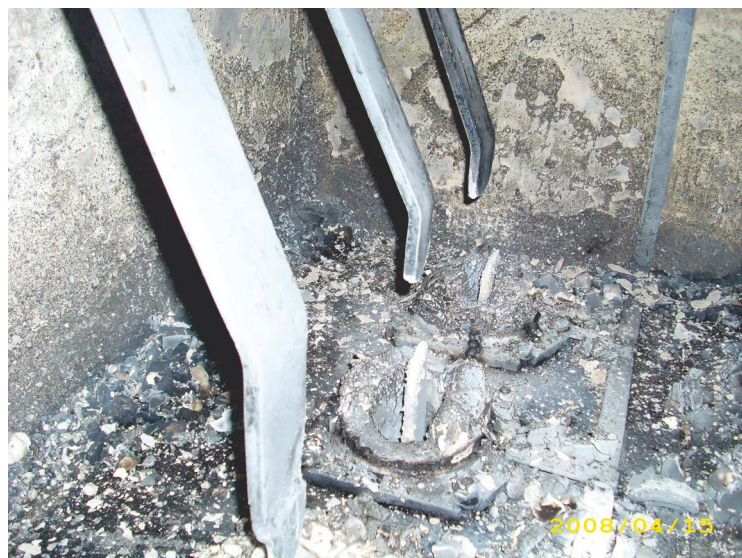
Fot. 4.3.2. Skutki zwarcia w polu rozdzielczym w KWK „Sośnica-Makoszowy”
