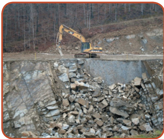
Fot. 4. Miejsce zsunięcia się fragmentu ściany w KOP „Tenczyn”
