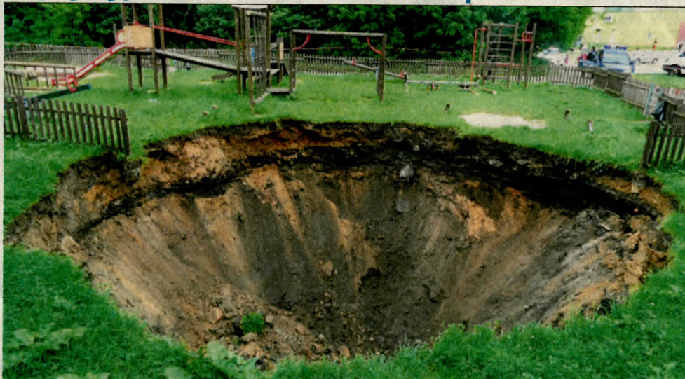
Zapadlisko na Dańdówce spowodował biedaszyb lub chodnik dawnej kopalni Niwka-Modrzejów
