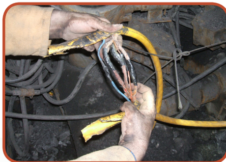
Nieprzestrzeganie zasad łączenia kabli
